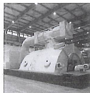
▲MACC発電 (川崎火力発電所)
