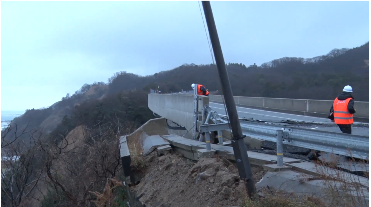
甲 1034 珠州市大谷ループ橋の損傷状況
