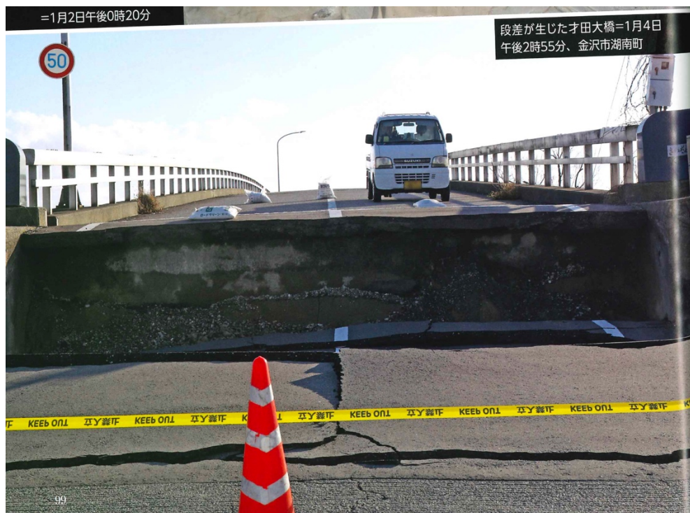
甲 1009 99 頁 橋と道路に大きな段差が生じた
